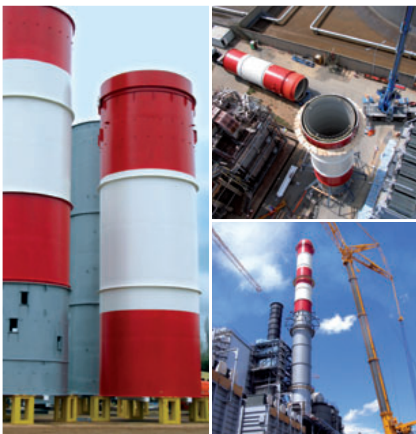
À gauche : SIMONA® E-CTFE-GK/plastique renforcé fibre de verre/acier in situ. En haut à droite : avant le montage de la dernière pièce de la cheminée. En bas à droite : cheminée entièrement montée.
